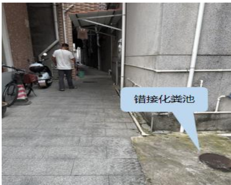
图5.2-73 现状住宅化粪池接入明沟
