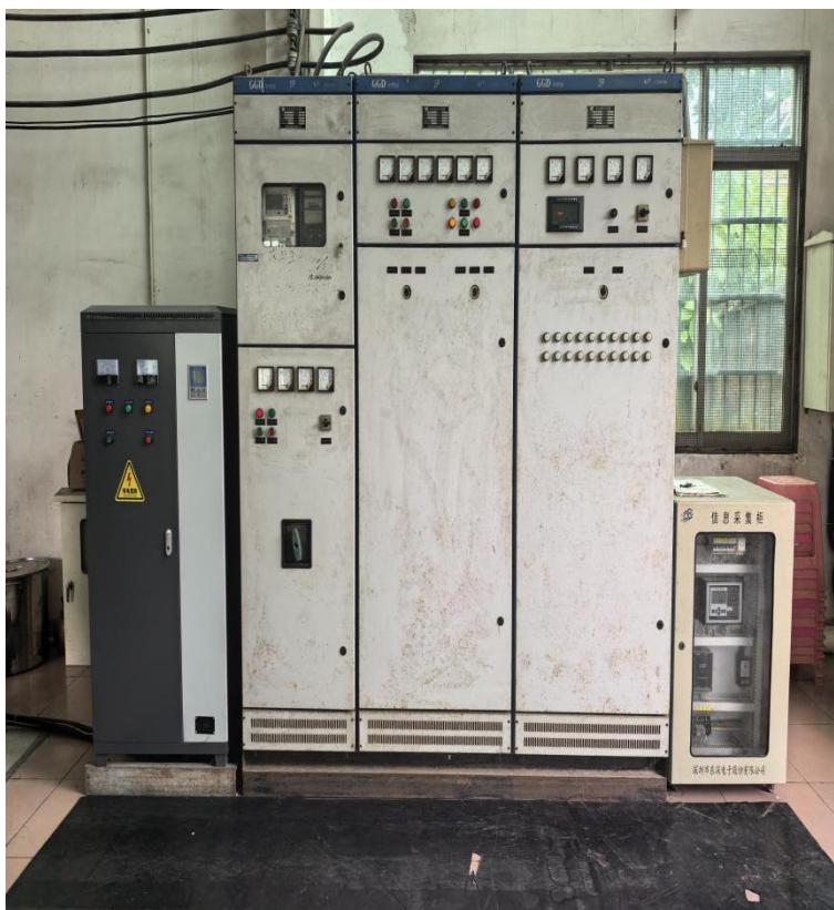
图5.2-99 钊墩新站低压配电柜
