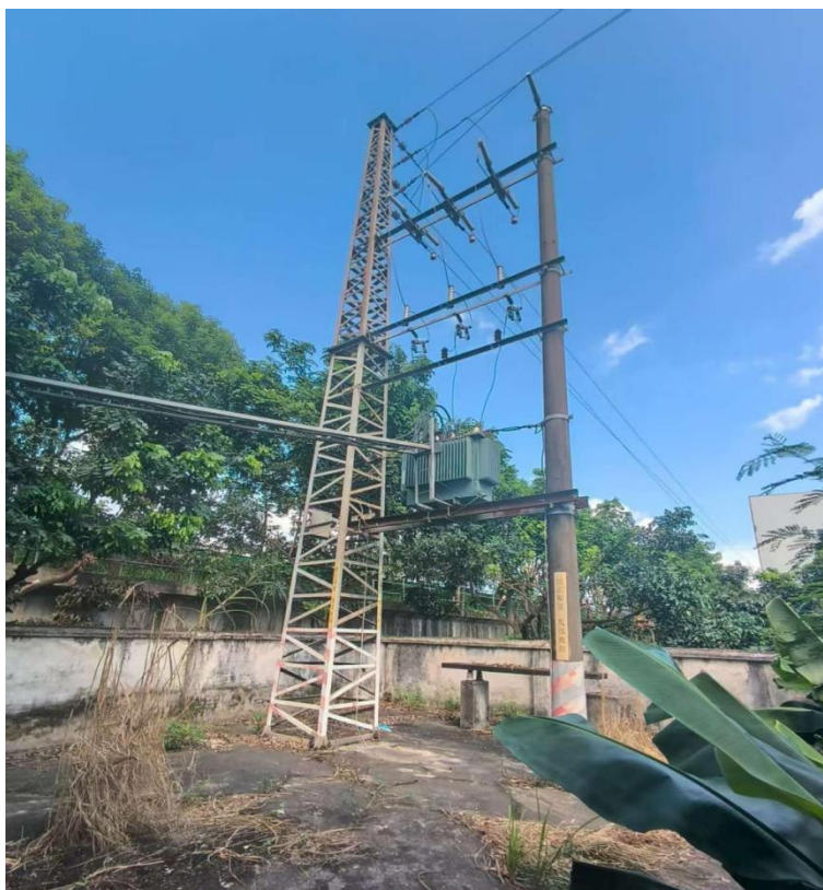
图5.2-102 卢溪2#排站户外变压器
