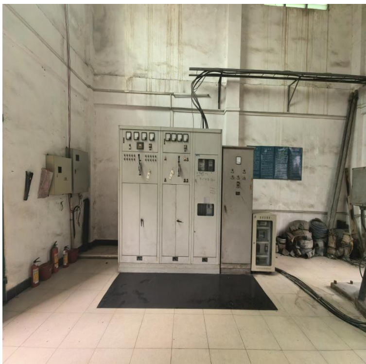
图5.2-103 卢溪2#排站低压配电柜
