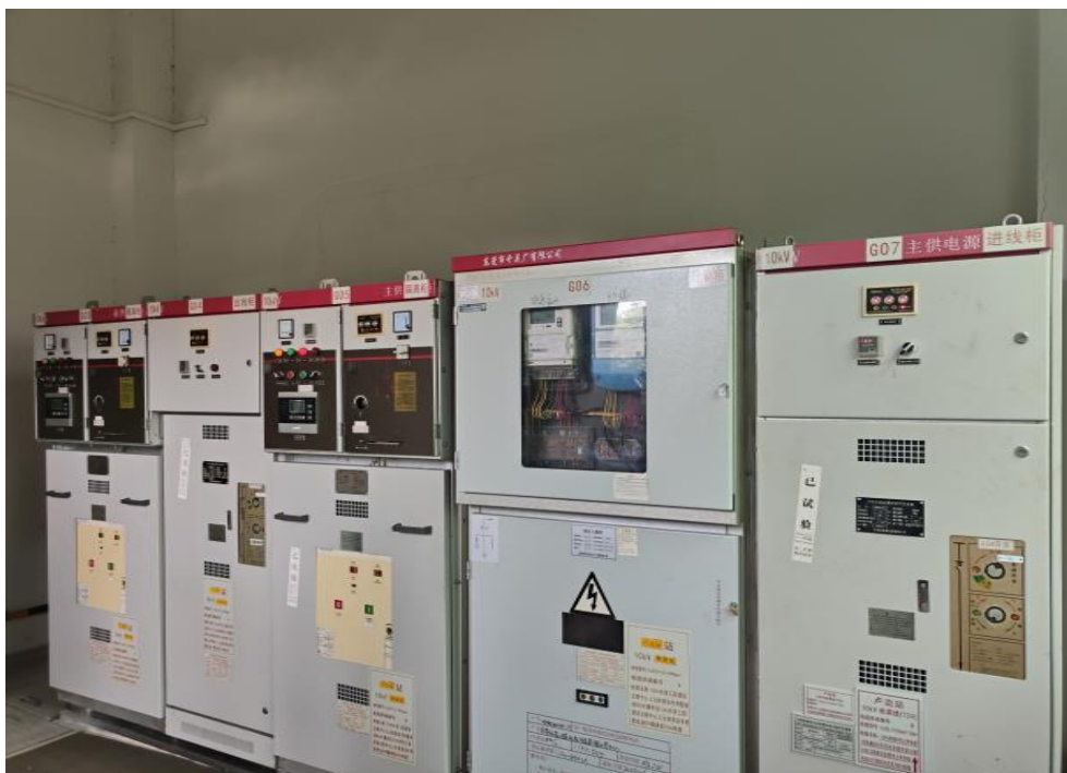
图5.2-88 上元新排站高压室
