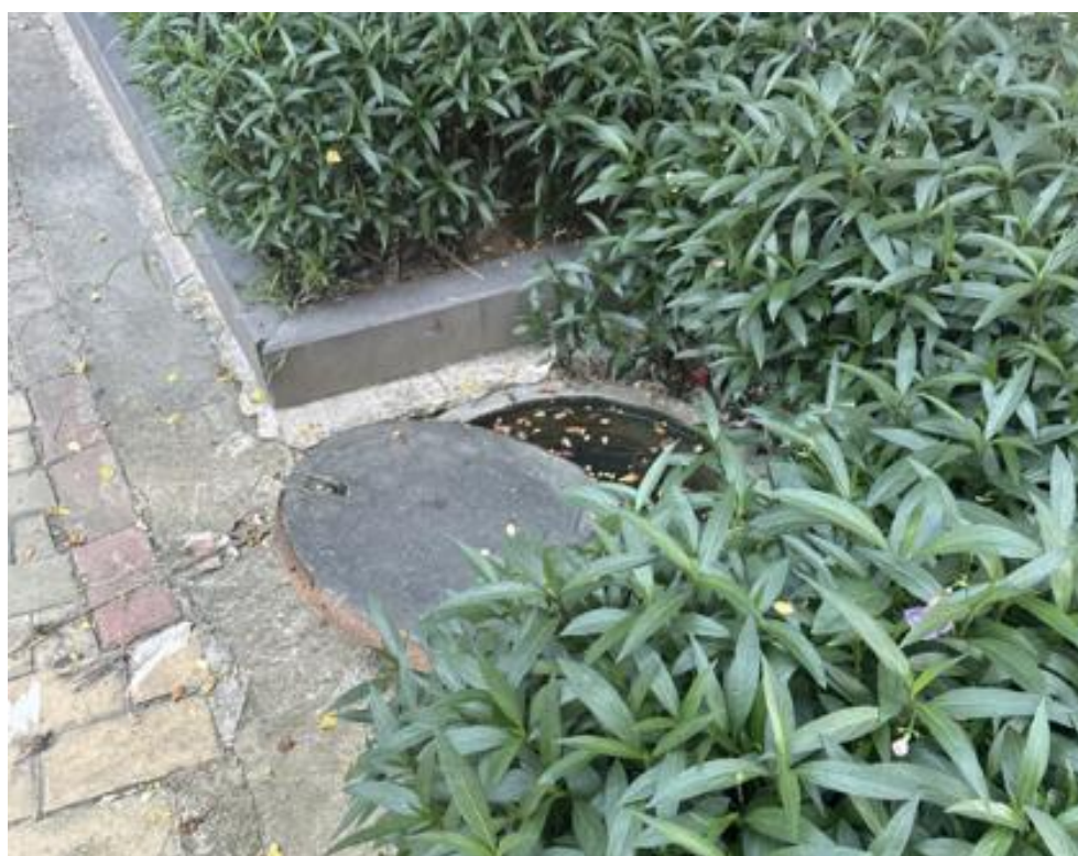
图5.2-74 现状污水管道连接问题
