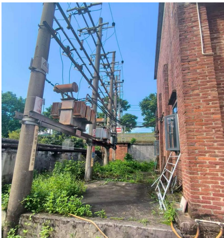
图5.2-98 钊墩新旧排站户外变压器
