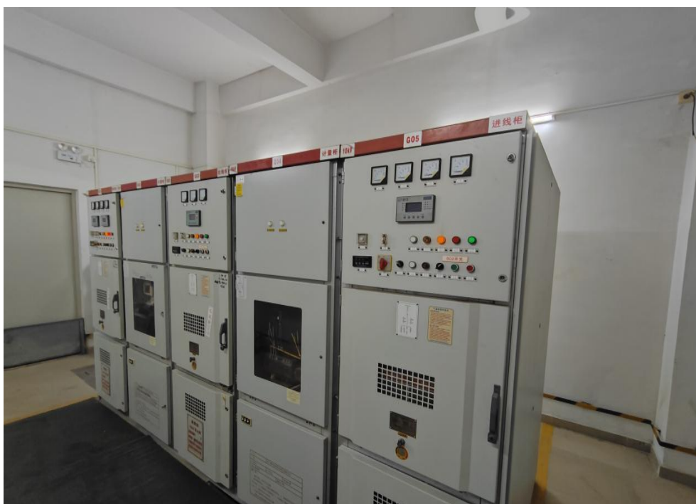
图5.2-96 四美洲新排站高压室
