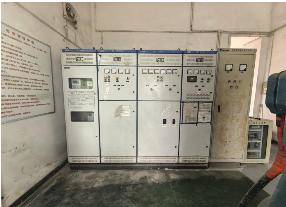
图5.2-93 上元3#排站现状低压配电柜
