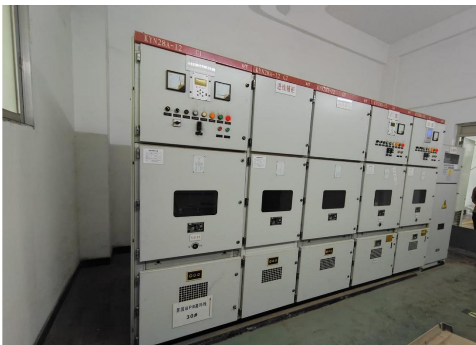
图5.2-84 东洲新排站高压室
