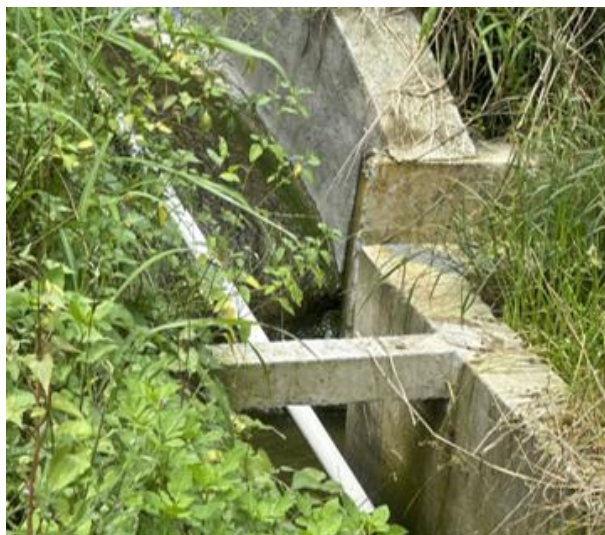
图5.2-70 现状雨水排口晴天有污水
