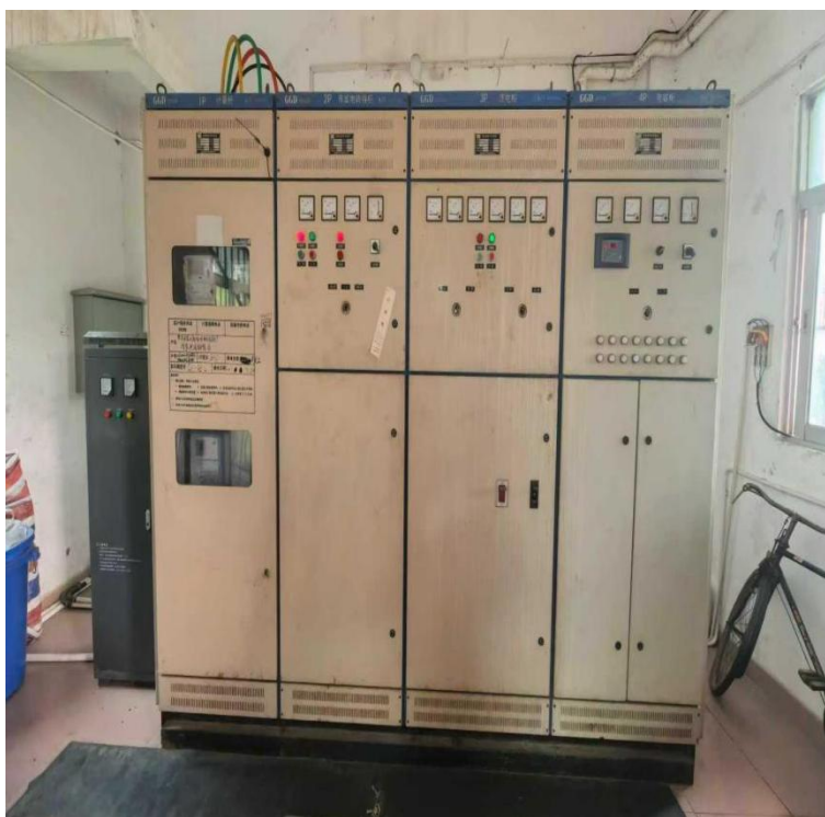
图5.2-101 北围排站低压配电柜
