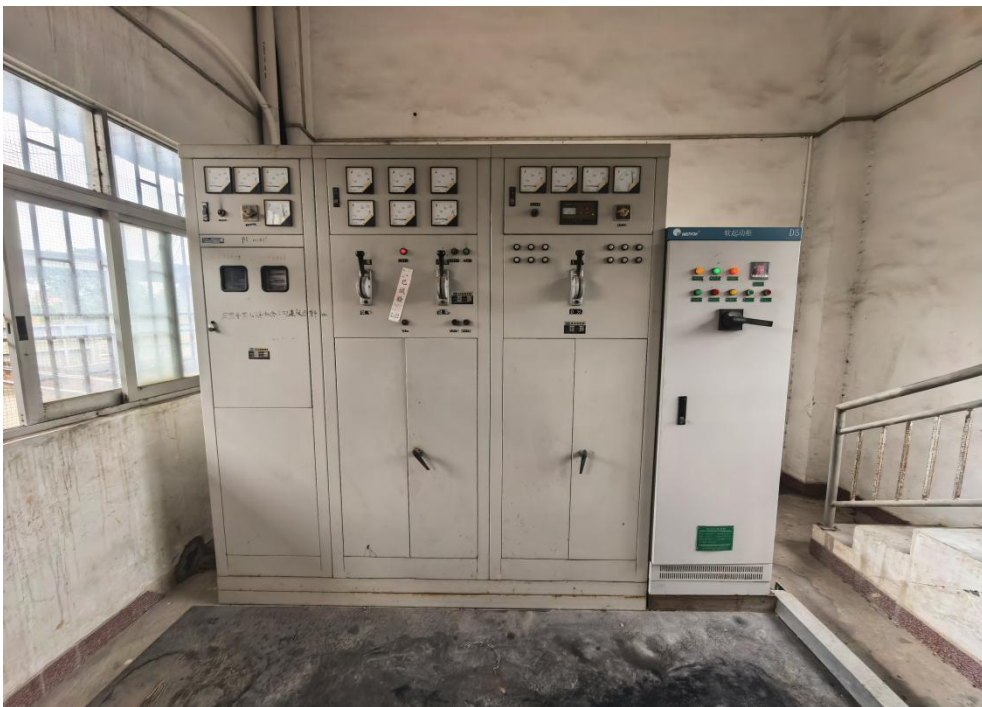
图5.2-91 上元2#排站现状低压配电柜
